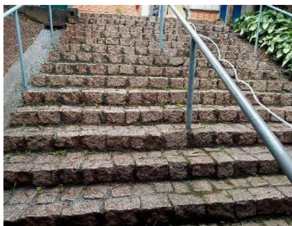
Figura 55: Escada da bocha suja e escorregadia
