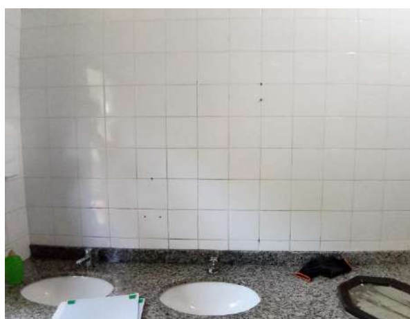
Figura 14: Sanitários sem sinalização
