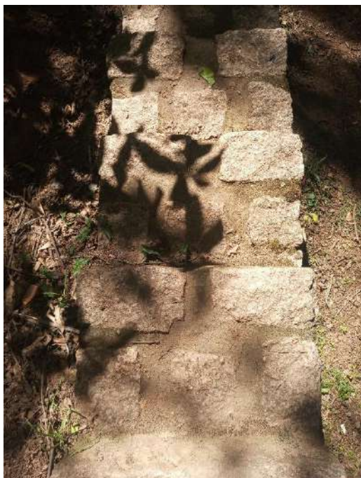
Figura 57: Escada do lago suja e escorregadia
